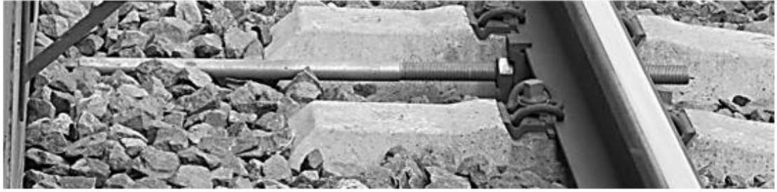
Rys 7 Przykład zabudowy urządzenia zapewniające niezmiennosc położenia osi toru względem obiektów stałych (przykładowe rozwiązanie)
