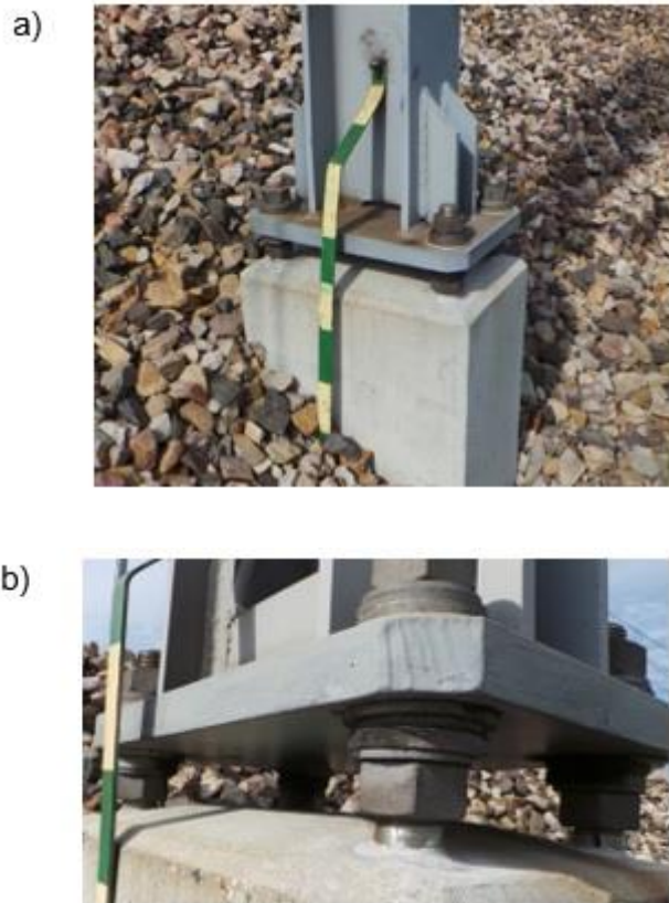
Rys 2.7.1. Słup trakcyjny, który wchodzi w skład systemu grupowego uszynienia otwartego: a) widok z góry połączenia słupa z fundamentem, b) widok z dołu połączenia z fundamentem izolowanego za pomocą przekładek i tulei izolacyjnych
