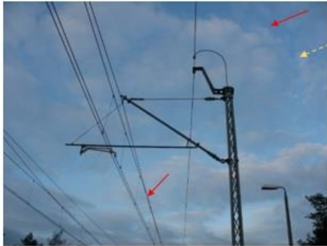
Rys 4.6.1. Przewody uszynienia grupowego nad siecią trakcyjną DC 3 kV (na górnym zdjęciu z lewej strony strzałką niebieską z linią przerywaną wskazano linię niezmodyfikowaną, wykonaną w systemie uszynienia bezpośredniego - bez przewodu uszynienia grupowego)
