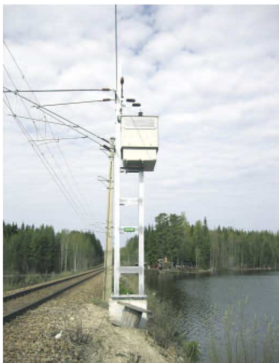
Rys.6.3.11. Booster transformator na kolejach szwedzkich
