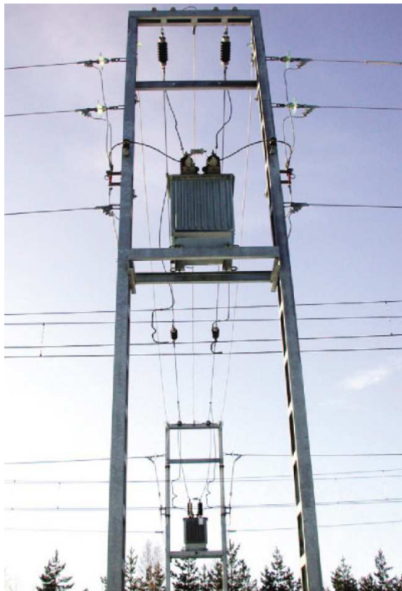
Rys.6.3.10. Booster transformatory na kolejach fińskich
