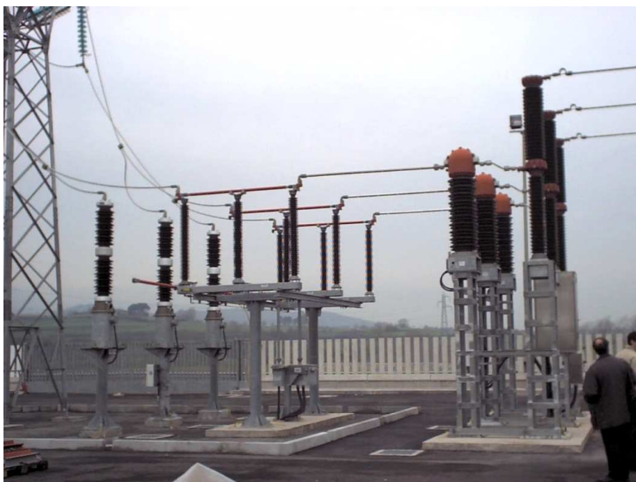
Rys. 6.8.2. Wejście linii WN do rozdzielni WN na podstacji
