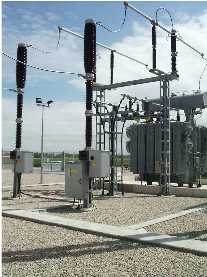
Rys. 6.3.1. Widok dwubiegunowego wyłącznika 220 kV
