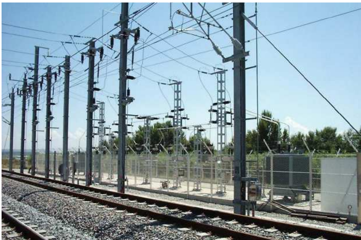
Rys. 6.3.8. Kabina sekcyjna z autotransformatarami
