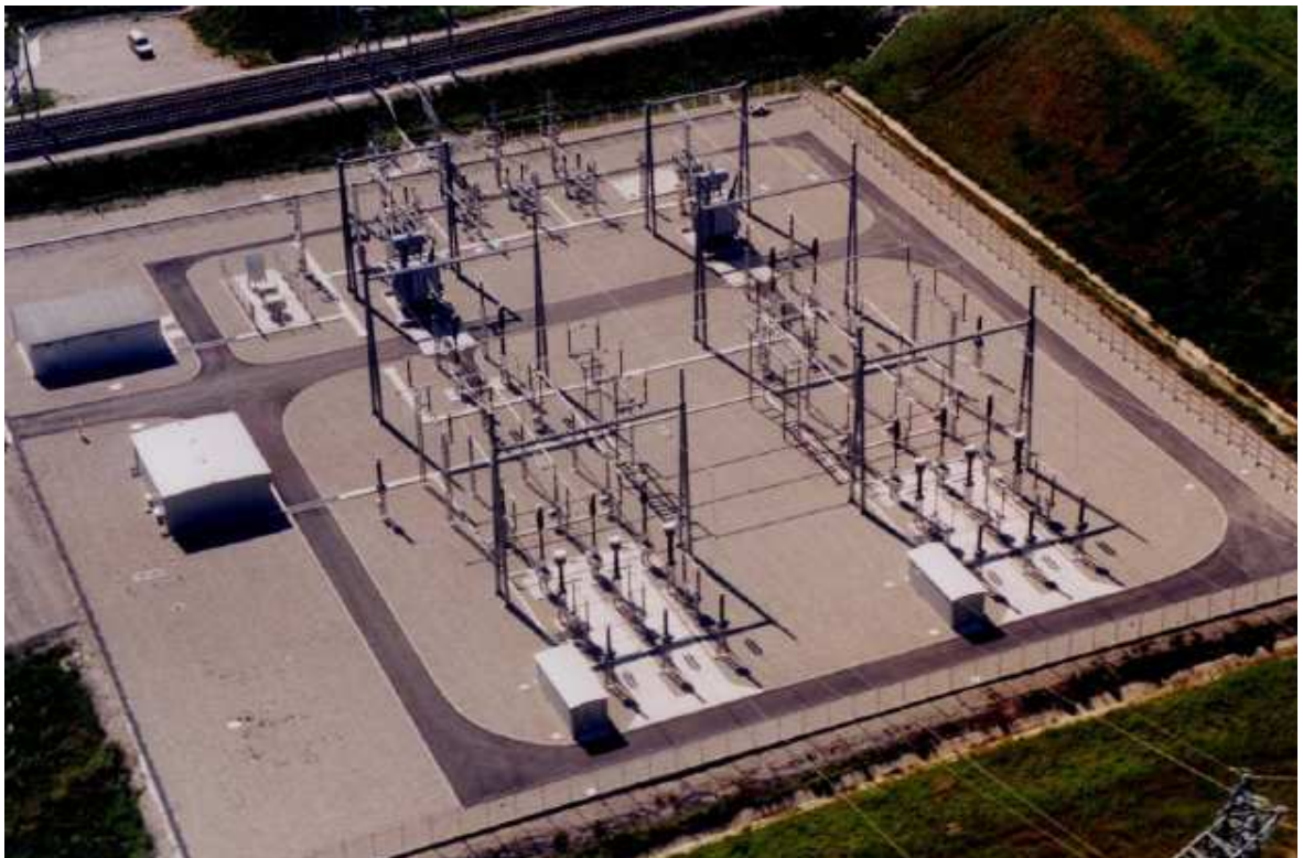
Rys. 4.3.5. Widok podstacji trakcyjnej zasilanej napięciem 225 kV
