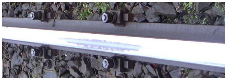
Rys. 12 Przykład nieciągłości reprofilacji spowodowany występowaniem długich fal
