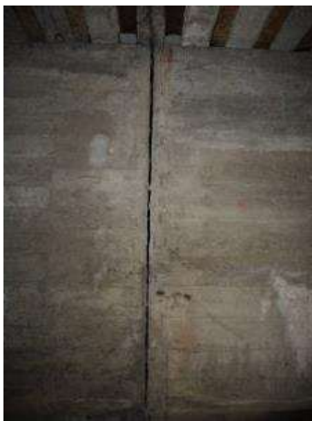
Foto 40. Jedna ze szczelin dylatacyjnych w jednym z wysokich przepustów koło Tarnowskich Gór. Szczeliny te stanowią schronienie dzienne dla kilku gatunków nietoperzy: gacka brunatnego, nocka dużego, nocka Natterera i mroczka późnego, km 4,300 LK 182, 12.08.2016.
