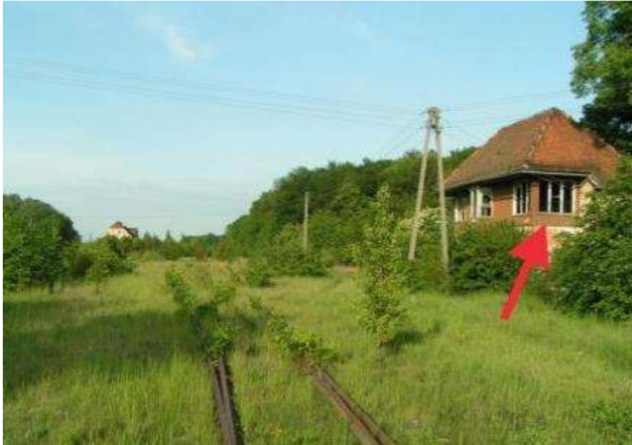
Foto 39. Budynek nieczynnej nastawni kolejowej w Roztoce, w którym pod drewnianym obiciem zewnętrznych ścian stwierdzono kolonię mopka, LK 302.
