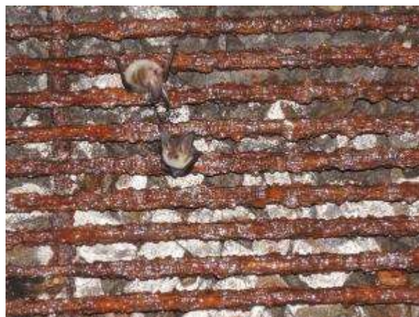
Foto 30. Gacki brunatne w otworze wentylacyjnym w stropie jednego z wysokich przepustów koło Tarnowskich Gór, km 4,300 LK182, 12.08.2016.
