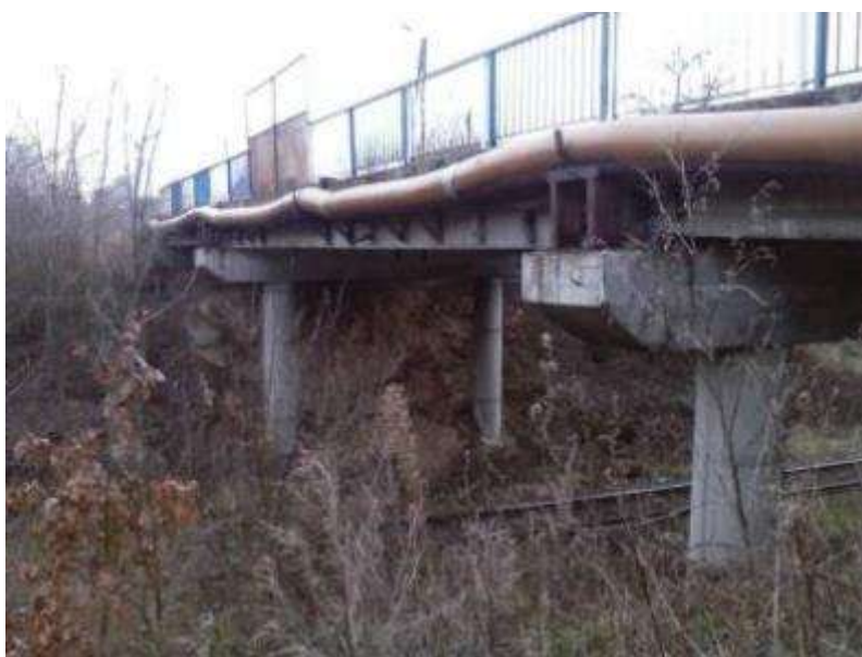
Foto 6. Wiadukt w Rakłowicach, w którym stwierdzono kolonię nietoperzy. Nietoperze zajmowały szczeliny w spodniej części wiaduktu.
