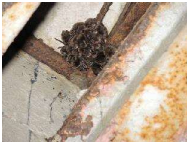
Foto 33. Kolonia nocka rudego w szczelinie w stropie jednego z wysokich przepustów koło Tarnowskich Gór, km 4,300 LK 182, 12.08.2016.
