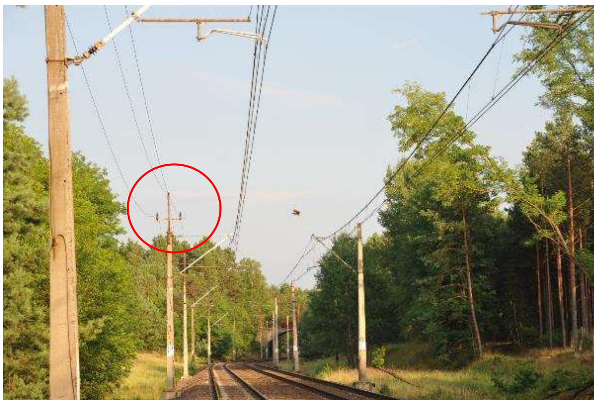
Fotografia 5-1 Odcinek 3 bielik startujący ze słupa trakcyjnego. Kołem zaznaczono niebezpieczne elementy podane w literaturze, znajdujące się na Linii Potrzeb Nietrakcyjnych
